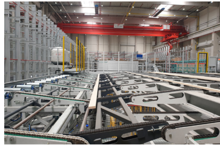
Leisse zeichnet in Bremerhaven für die gesamte Mechanisierung sowie das Anlagenkonzept verantwortlich
